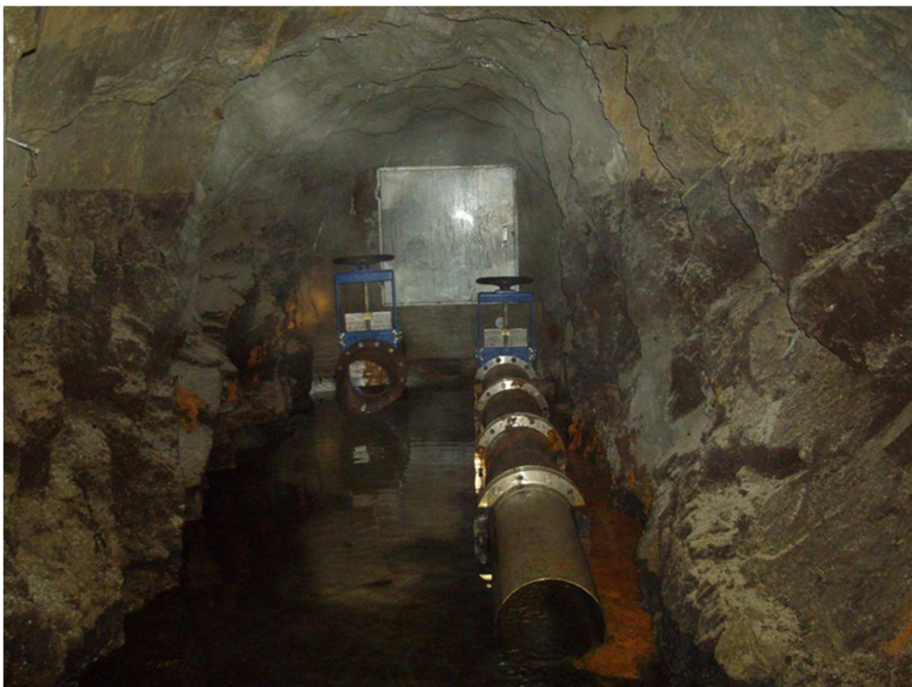
Die nach der Überschwemmung von 2005 eingesetzte Betonplombe Bild aus eigener Begehung
